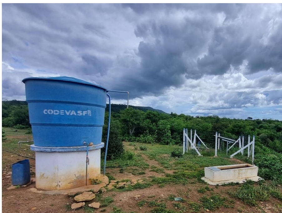
Foto 78: Sistema com poço profundo e placas fotovoltaicas instalado pela Codevasf, situado no distrito de Cachoeira Grande, município de Poranga. Coordenadas: Este – 256.551 ; Norte – 9.491.025.
