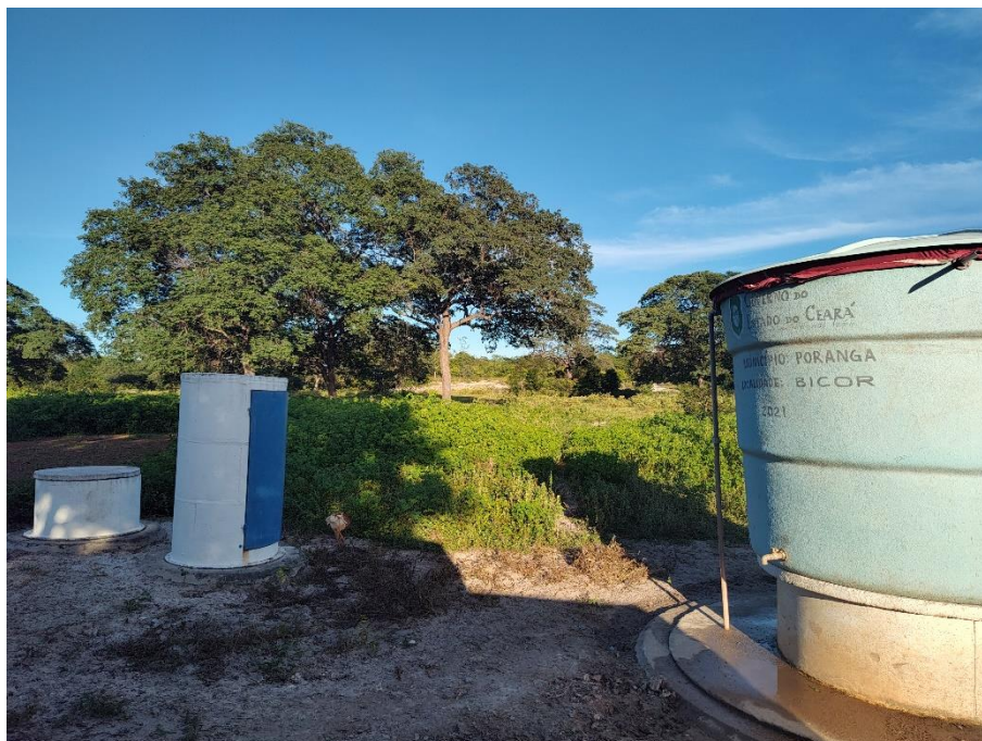
Foto 99: Poço profundo da prefeitura de Poranga, instalado pelo Governo do Ceará, situado na localidade de Bicór, município de Poranga. Coordenadas: Este – 258.516 ; Norte – 9.455.026.
