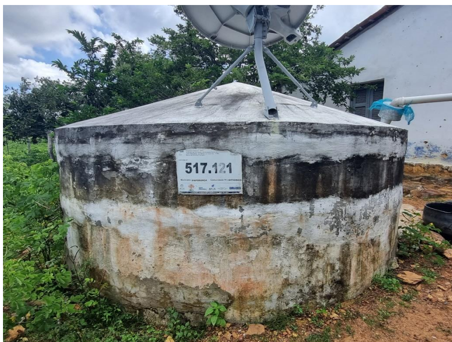
Foto 68: Cisterna da prefeitura de Ipaporanga, situada na localidade de Teotonio, município de Ipaporanga. Coordenadas: Este – 274.756 ; Norte – 9.447.230.
