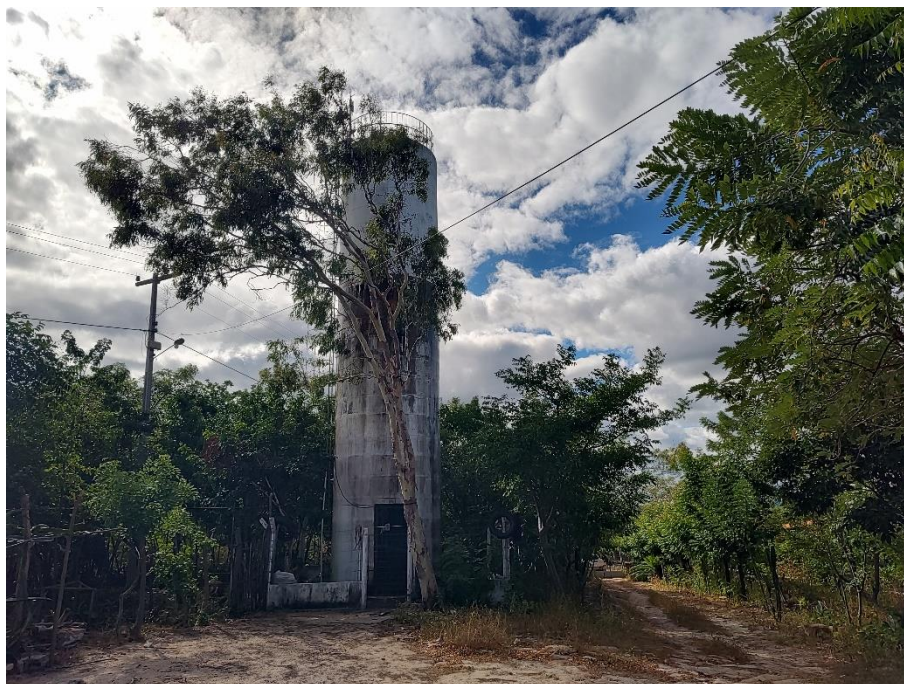
Foto 107: Torre de abastecimento do SISAR, instalada pelo Governo do Ceará, situada na localidade de Casa de Pedras, município de Guaraciaba do Norte. Coordenadas: Este – 268.253 ; Norte – 9.532.112.
