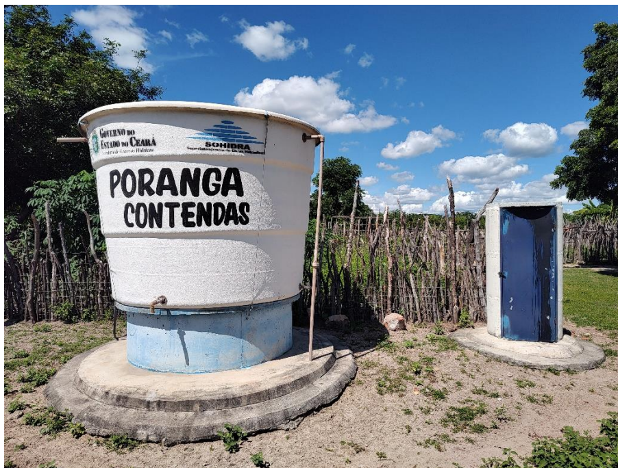
Foto 97: Poço profundo da prefeitura de Poranga, instalado pelo Governo do Ceará, situado na localidade de Contendas, município de Poranga. Coordenadas: Este – 263.259 ; Norte – 9.465.368.
