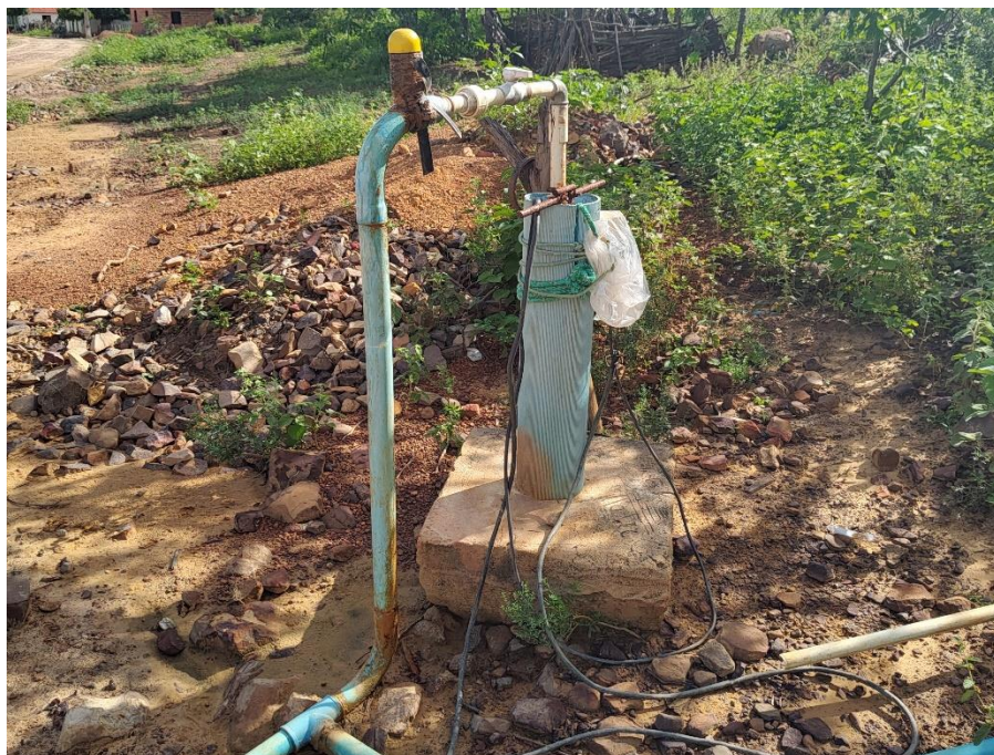
Foto 91: Poço profundo da prefeitura de Poranga, situado na localidade de Pitombeira, município de Poranga. Coordenadas: Este – 254.968 ; Norte – 9.475.291.
