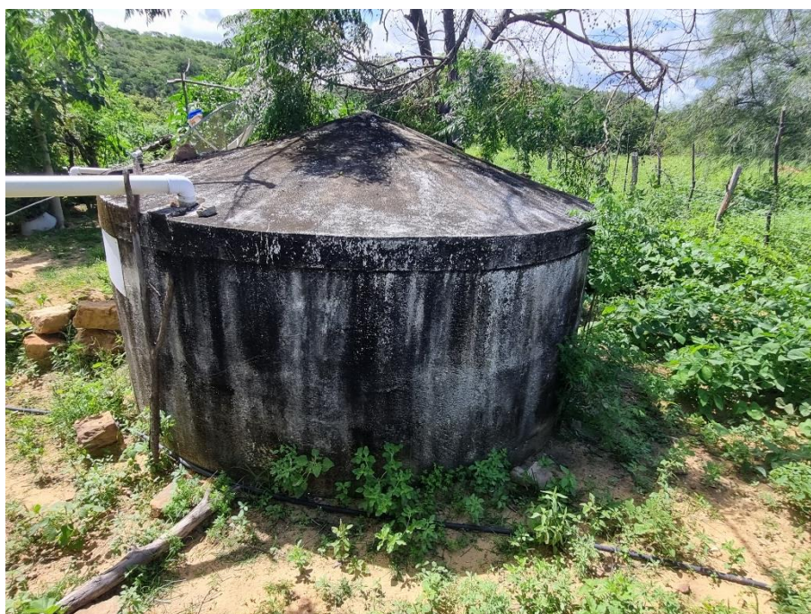
Foto 70: Cisterna da prefeitura de Iraporanga, situada na localidade de Pitombeira, município de Iraporanga. Coordenadas: Este – 277.493 ; Norte – 9.453.974.
