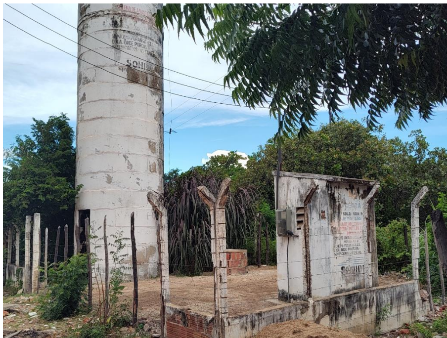
Foto 85: Torre de abastecimento do Projeto São José, da Secretaria do Desenvolvimento Agrário do Ceará (SDA), situado na localidade de Porcos, município de Poranga. Coordenadas: Este – 274.131 ; Norte – 9.487.343.
