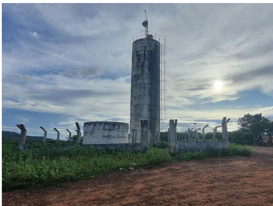
Foto 80: Torre de abastecimento do Projeto São José da Secretaria do Desenvolvimento Agrário do Ceará (SDA), situado no distrito de Cachoeira Grande, município de Poranga. Coordenadas: Este – 256.351 ; Norte – 9.491.567.
