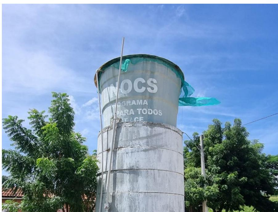
Foto 60: Cisterna da prefeitura de Crateús, situada na localidade de Alto Bonito, município de Crateús. Coordenadas: Este – 279.418 ; Norte – 9.442.359.
