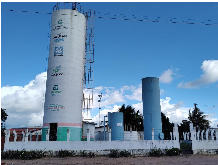
Foto 104: Torre de abastecimento do SISAR, instalada pelo Governo do Ceará, situada na localidade de Cabeça da Onça, município de Crateús. Coordenadas: Este – 287.784 ; Norte – 9.396.494.
