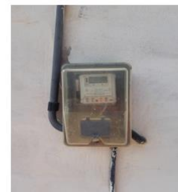
Exemplo de medidor de energia na área de litígio.
