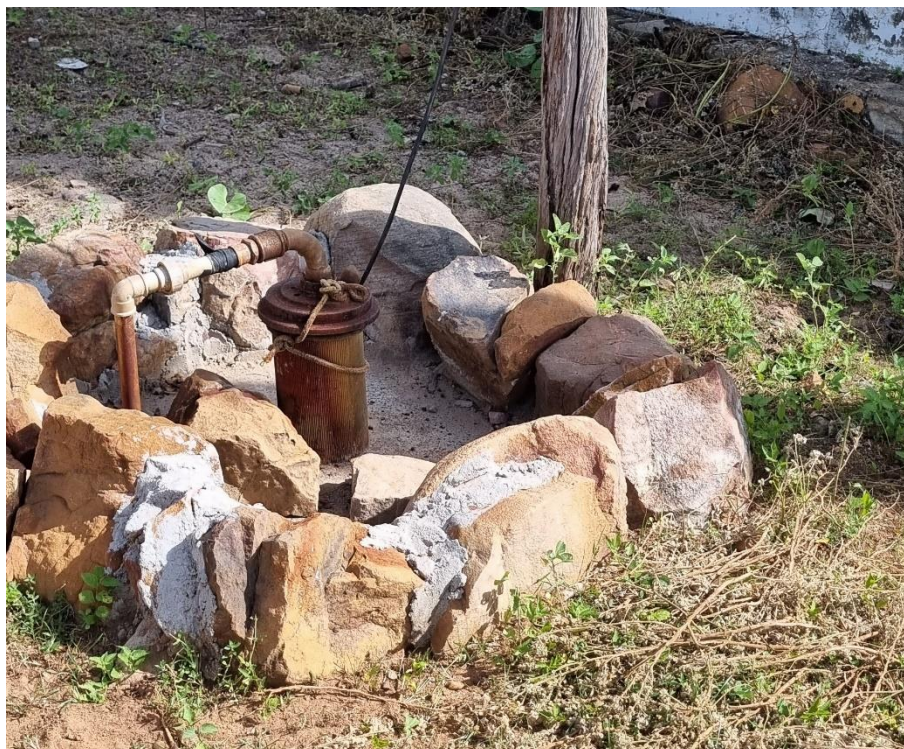
Foto 75: Poço profundo da prefeitura de Ipueiras, situado na localidade de Mel, município de Ipueiras. Coordenadas: Este – 264.256 ; Norte – 9.493.487.
