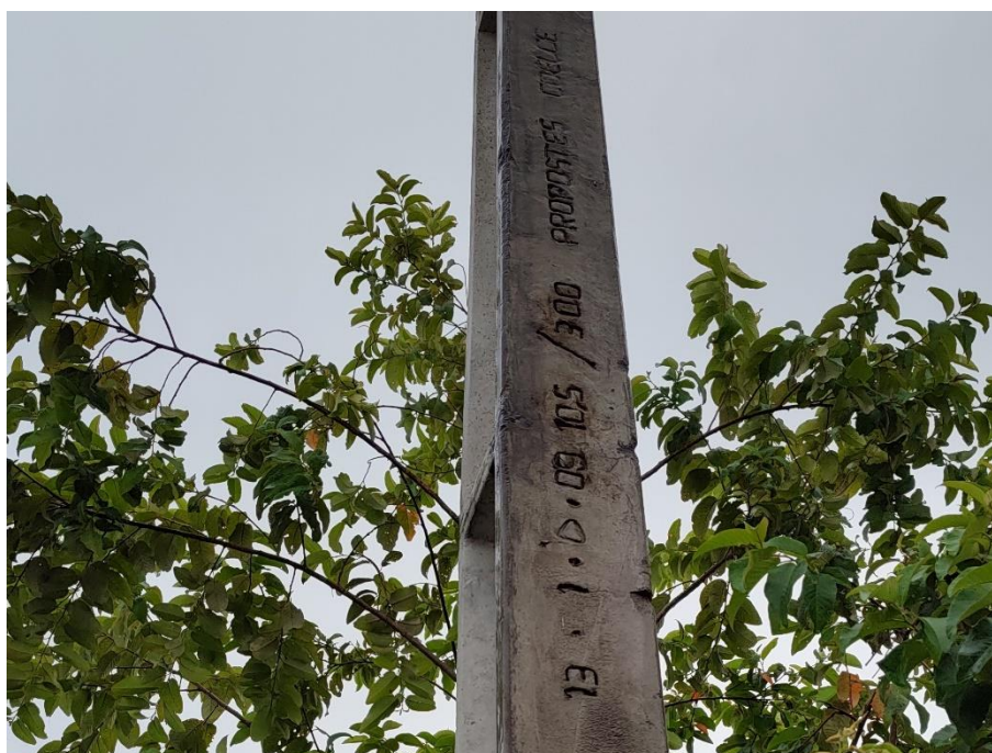
Foto 142: Poste da Enel, situado na localidade de Retirana, município de Buriti dos Montes. Coordenadas: Este – 286.590 ; Norte – 9.409.637.
