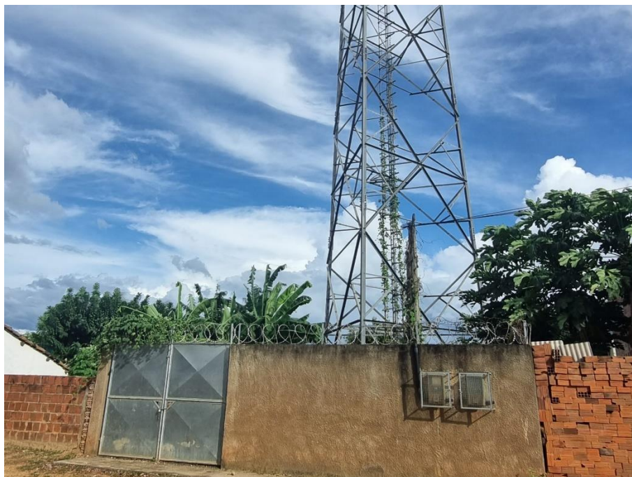
Foto 143: Torre de telefonia, situada no distrito de Cachoeira Grande, Município de Poranga. Coordenadas: Este – 256.470 ; Norte – 9.491.552.
