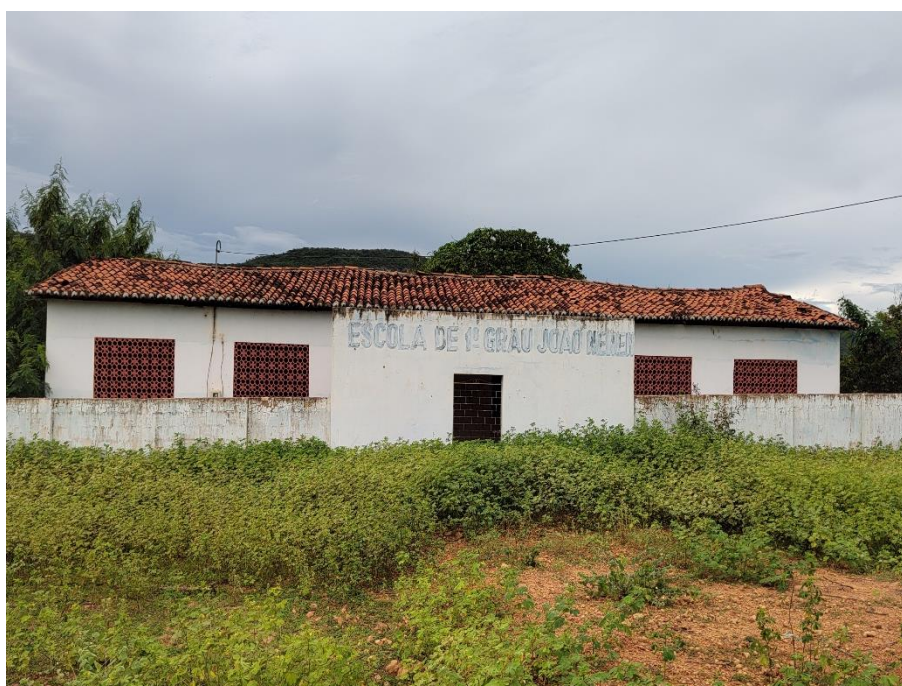
Foto 8: Escola de Ensino Fundamental João Neném (em reforma), situada na localidade de Sítio Novo, Poranga. Administrada pelo município de Poranga. Coordenadas: Este – 267.865 ; Norte – 9.486.211.
