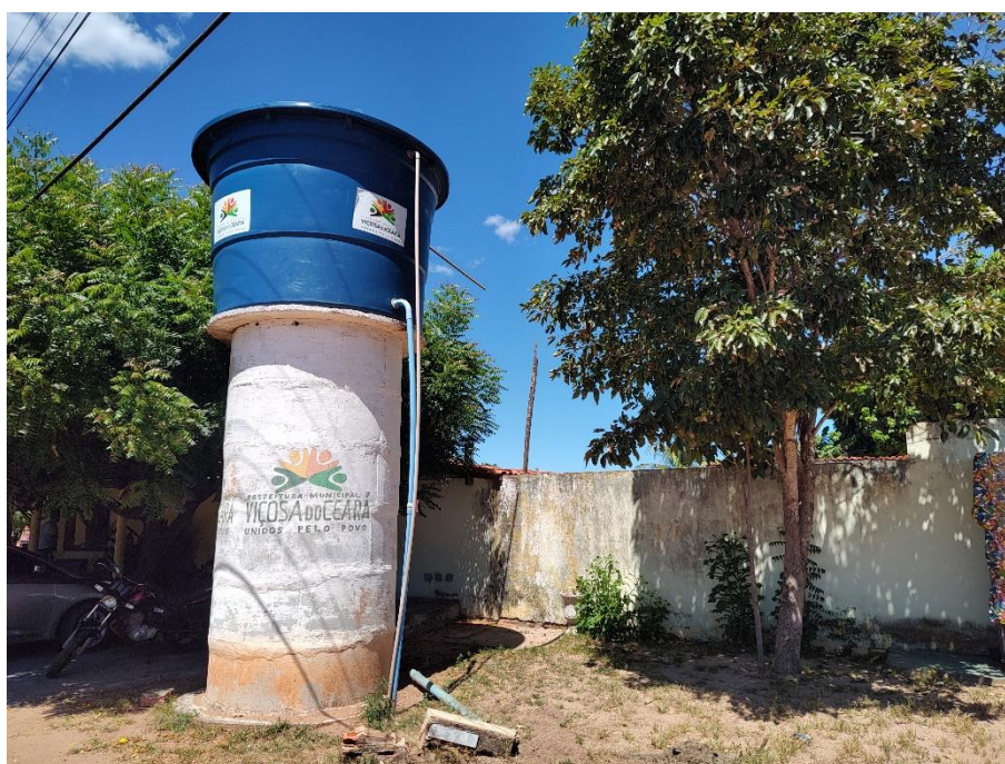
Foto 114: Poço profundo da prefeitura de Viçosa do Ceará, situado na localidade de Pirapora, município de Viçosa do Ceará. Coordenadas: Este – 236.930 ; Norte – 9.606.011.
