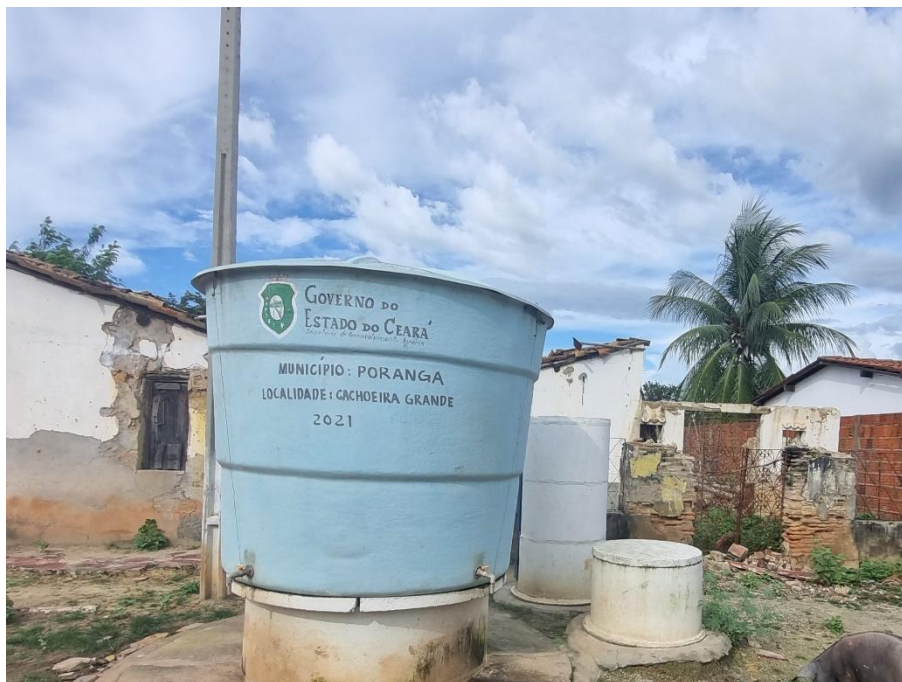
Foto 79: Poço profundo da prefeitura de Poranga instalado pela Secretaria do Desenvolvimento Agrário do Ceará (SDA), situado no distrito de Cachoeira Grande, município de Poranga. Coordenadas: Este – 256.502 ; Norte – 9.491.594.
