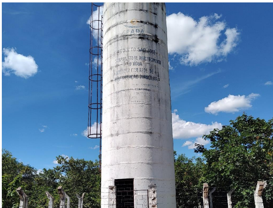
Foto 96: Torre de abastecimento do Projeto São José da Secretaria do Desenvolvimento Agrário do Ceará (SDA), situado na localidade de Contendas, município de Poranga. Coordenadas: Este – 262.911 ; Norte – 9.466.187.
