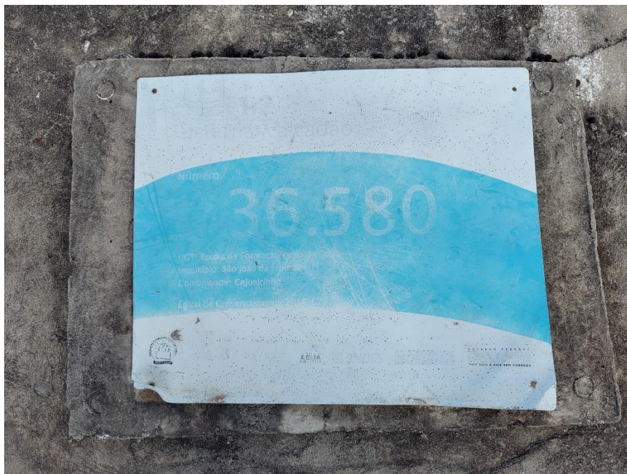
Foto 109: Cisterna da prefeitura de São João da Fronteira, situada na localidade de Cajueirinho, município de Ibiapina. Coordenadas: Este – 251.556 ; Norte – 9.555.796.
