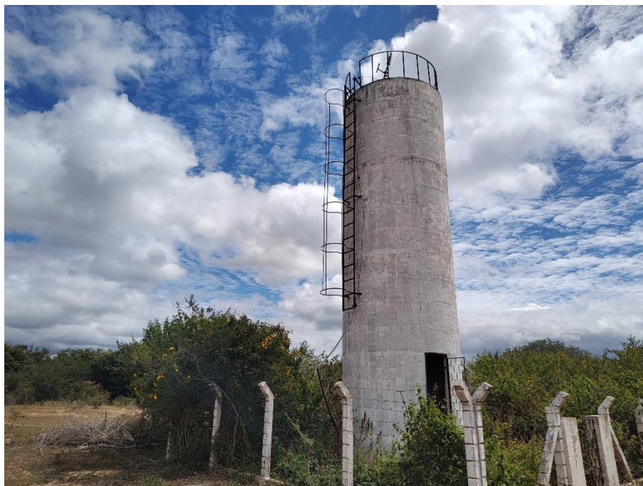
Fotos 111: Torre de abastecimento do SISAR, instalada pelo Governo do Ceará, situada na localidade de Santa Maria, município de Viçosa do Ceará. Coordenadas: Este – 252.561 ; Norte – 9.589.624.
