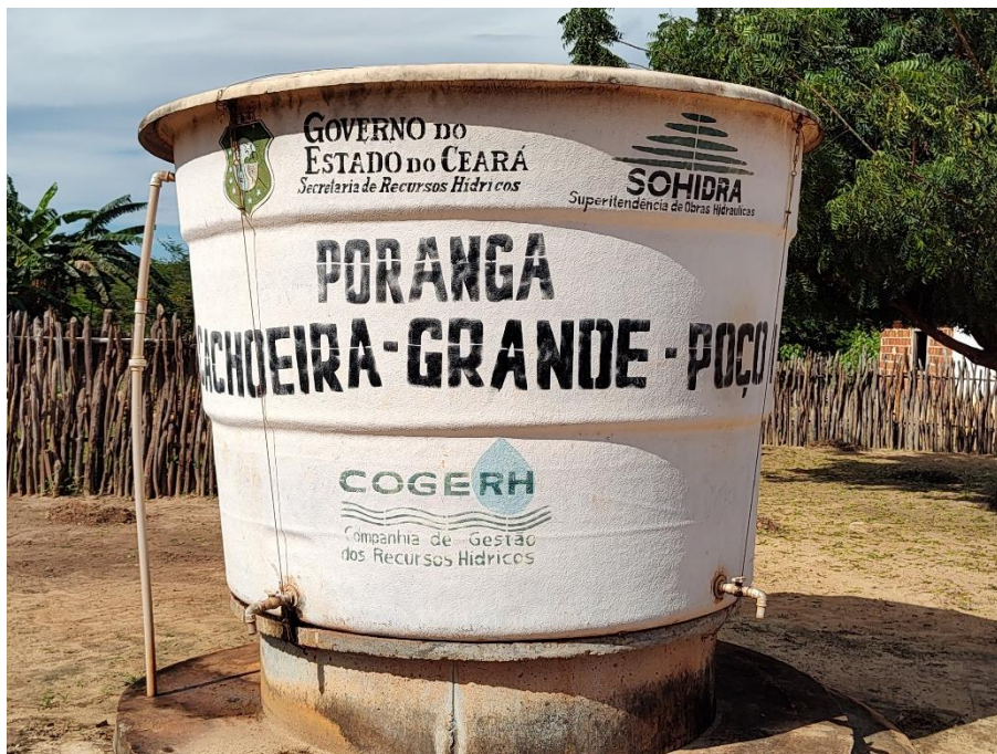
Foto 81: Poço profundo da prefeitura de Poranga, instalado pela Companhia de Gestão dos Recursos Hídricos (COGERH), situada no distrito de Cachoeira Grande, município da Poranga. Coordenadas: Este – 255.975 ; Norte – 9.491.520.
