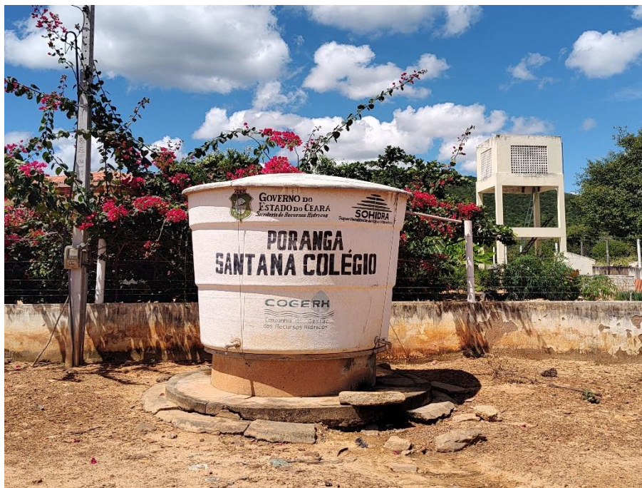
Foto 95: Poço profundo da prefeitura de Poranga, instalado pelo Governo do Ceará, situado no distrito de Macambira, município de Poranga. Coordenadas: Este – 267.315 ; Norte – 9.469.382.
