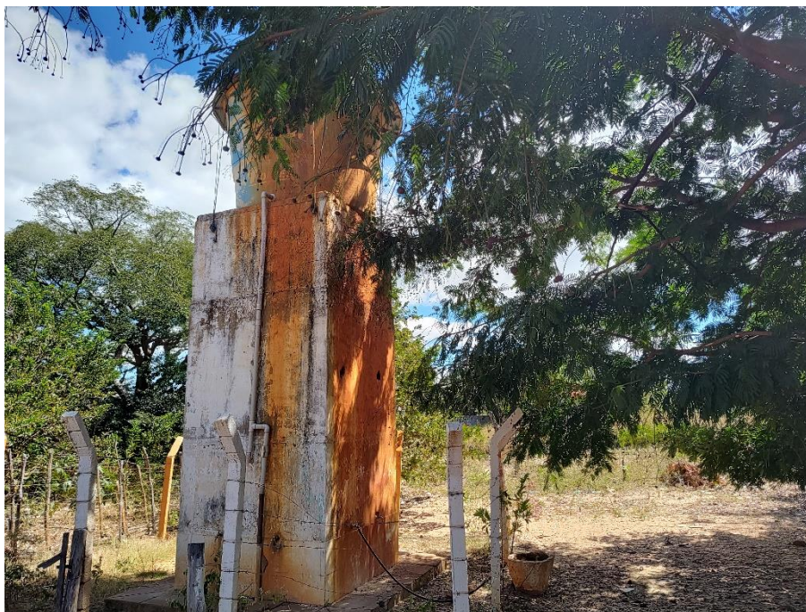
Foto 116: Caixa d'água da prefeitura de Guaraciaba do Norte, situada na localidade de Olho D'aguinha, município de Guaraciaba do Norte. Coordenadas: Este – 264.867 ; Norte – 9.530.451.
