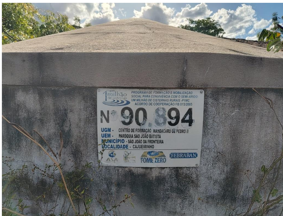
Foto 110: Cisterna da prefeitura de São João da Fronteira, situada na localidade de Cajueirinho, município de Ibiapina. Coordenadas: Este – 252.040 ; Norte – 9.555.919.
